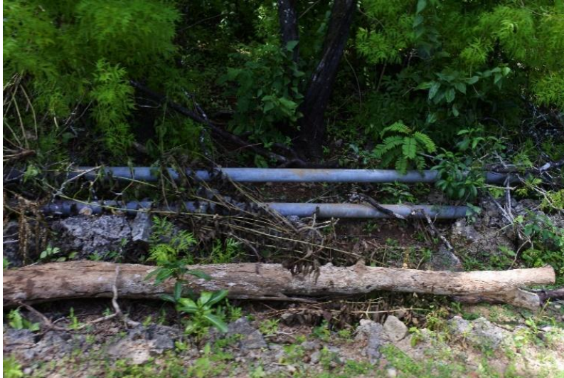
Gambar 6. 11 Jaringan Pipa Distribusi Air Desa Uiasa (Sumber: Dokumentasi Tim UGM, 2019)
