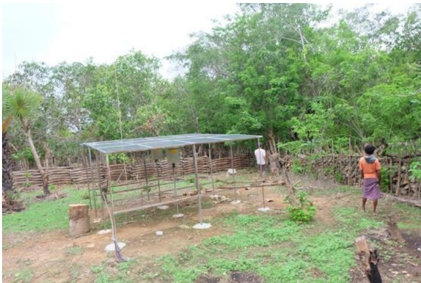
Gambar 6. 21 Solar Water Pumping System (SWPS) di Dusun 2 Desa Uiasa (Sumber: Dokumentasi Tim UGM, 2019)
